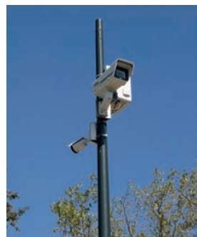
Depuis 2016, nous avons installé 21 caméras de vidéo-protection à Chantepie
